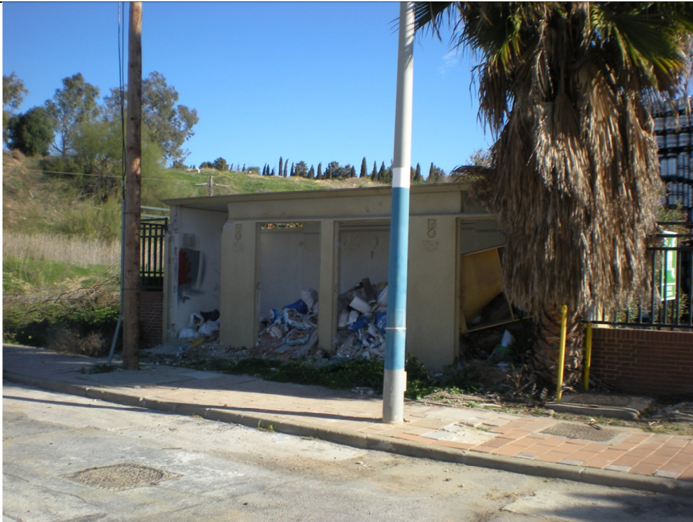
Caseta de instalaciones en calle Mercadante en estado precario (26-01-2023)
