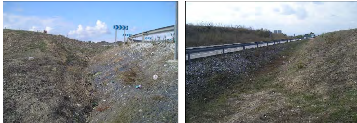
Ilustración 2: Detalle del drenaje actual en los ramales de salida e incorporación de la A-357.
