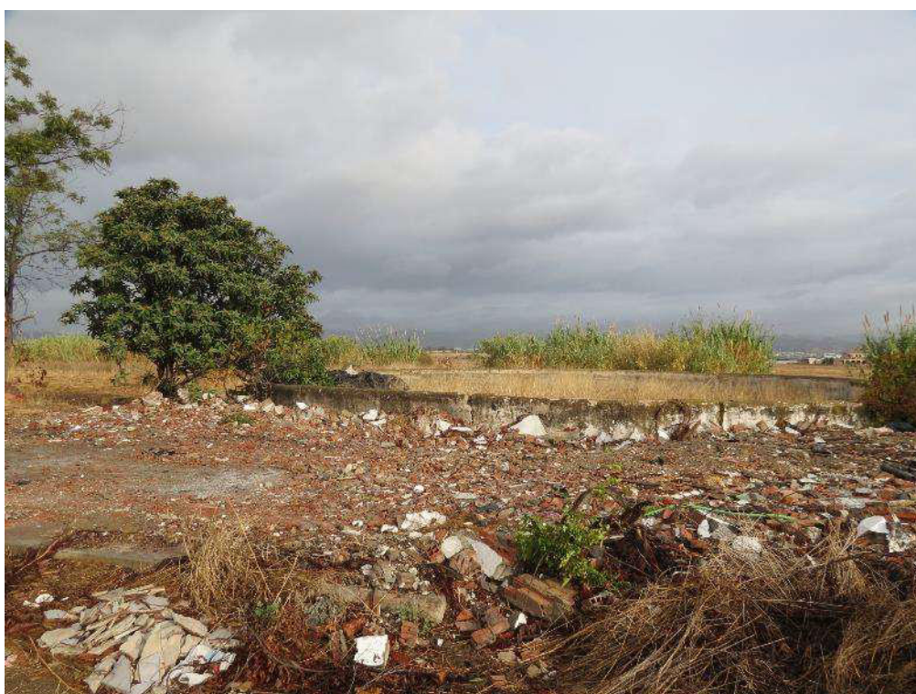
Restos de demolición
