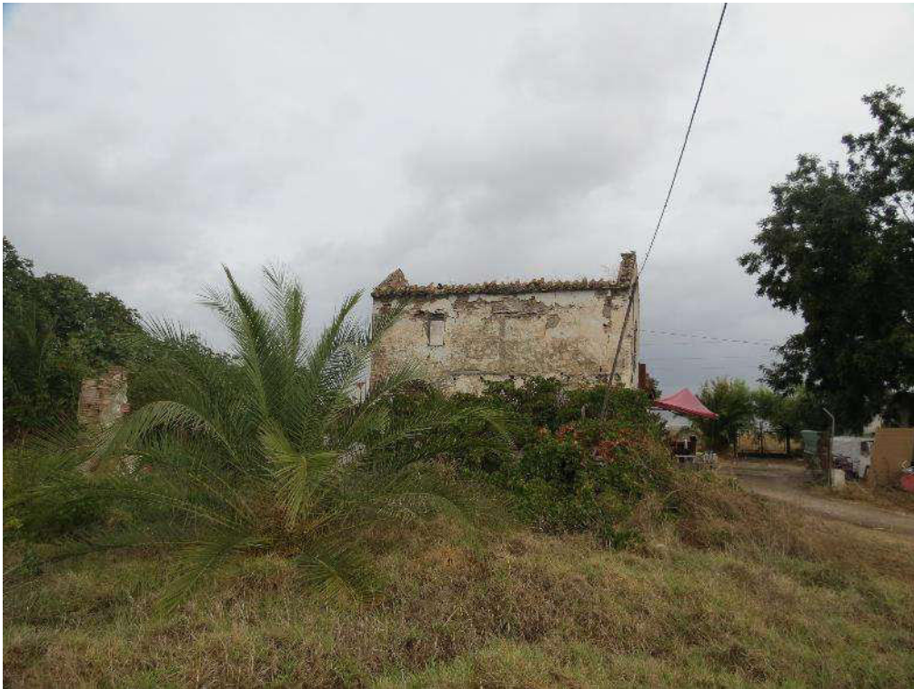
Edificación en ruinas.
