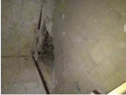
Hundimiento de forjado en planta tercera
