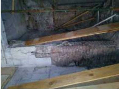
Grietas en soporte resistente.
