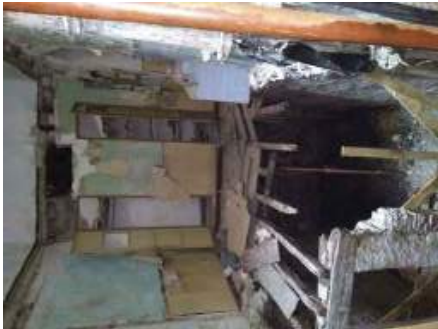
Hundimiento de forjado en planta primera
