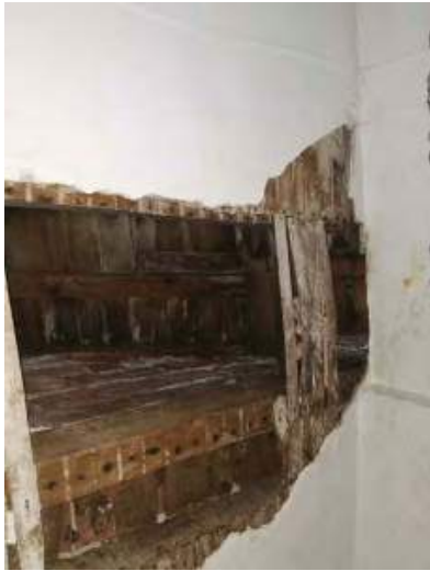
Deterioro de elementos estructurales de cubierta.
