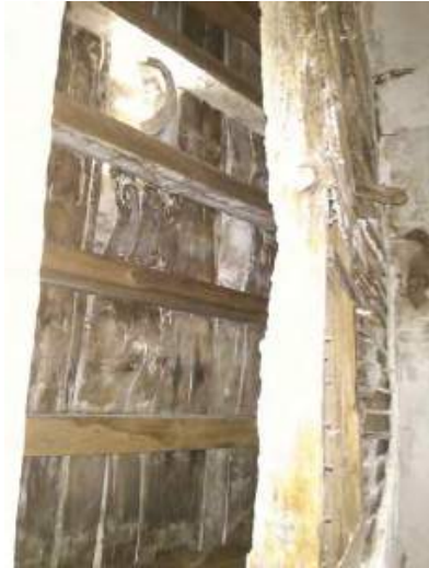
Pudrición y humedad en elementos estructurales de cubierta.
