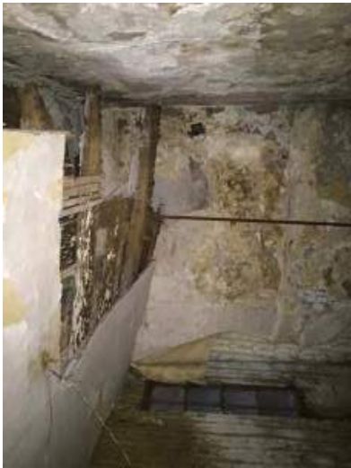
Colapso de elementos estructurales de cubierta.
