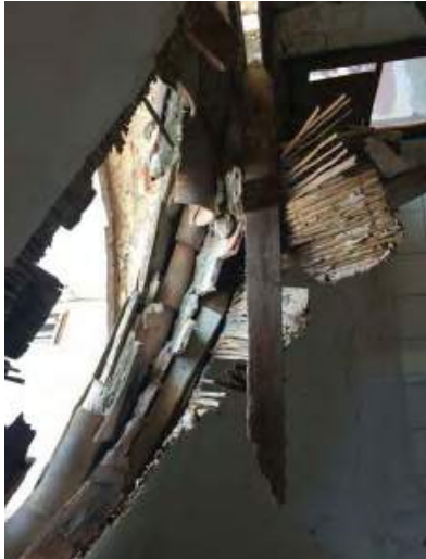
Colapso de paño de cubierta.
