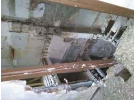
Hundimiento de forjado en planta primera y segunda
