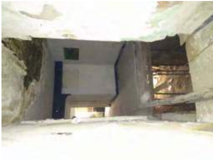
Hundimiento de forjado en planta primera
