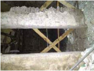
Desprendimiento de material en soporte resistente.
