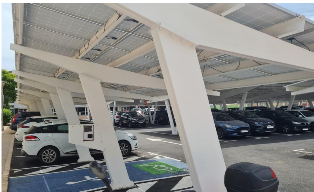
Ilustración. Ejemplo de marquesinas fotovoltaicas y punto de recarga.
