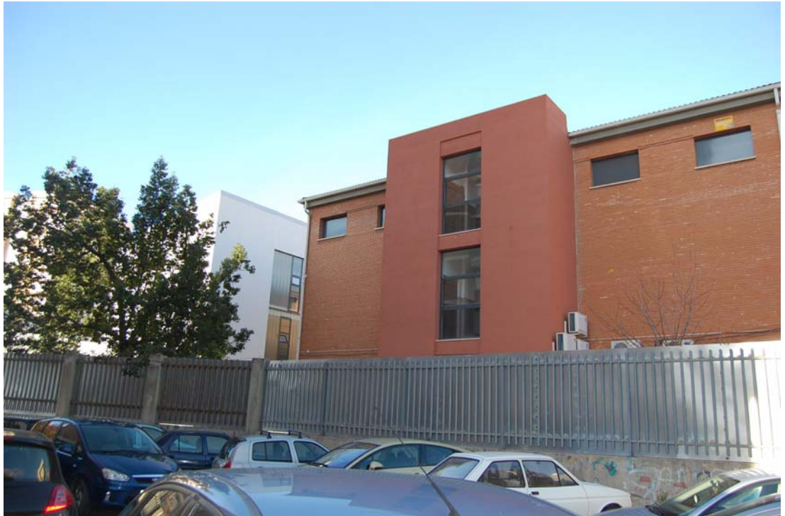
Fotografía 5. Colegio Público San José de Calasanz, zona afectada.
