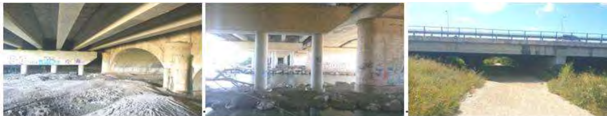
Ilustración 13. Fotografías tomadas bajo el paso de la primitiva N340a (actual MA-21), y aguas arriba, en visitas realizadas por este consultor, apreciándose que la sección más desfavorable se corresponde con el puente primitivo.
