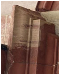
Alteraciones manchas amarillas y rojas
