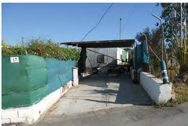
Construcción con vallado fuera normativa y pérgola.
