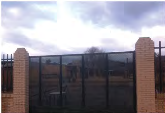
Muro fuera de normativa.
