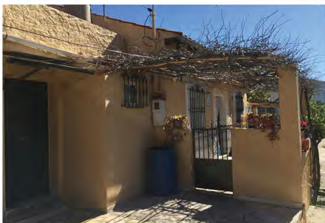
Vivienda con pérgola sin mantenimiento.
