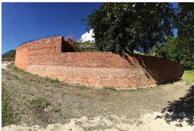
Muro de contención sin tratar.
