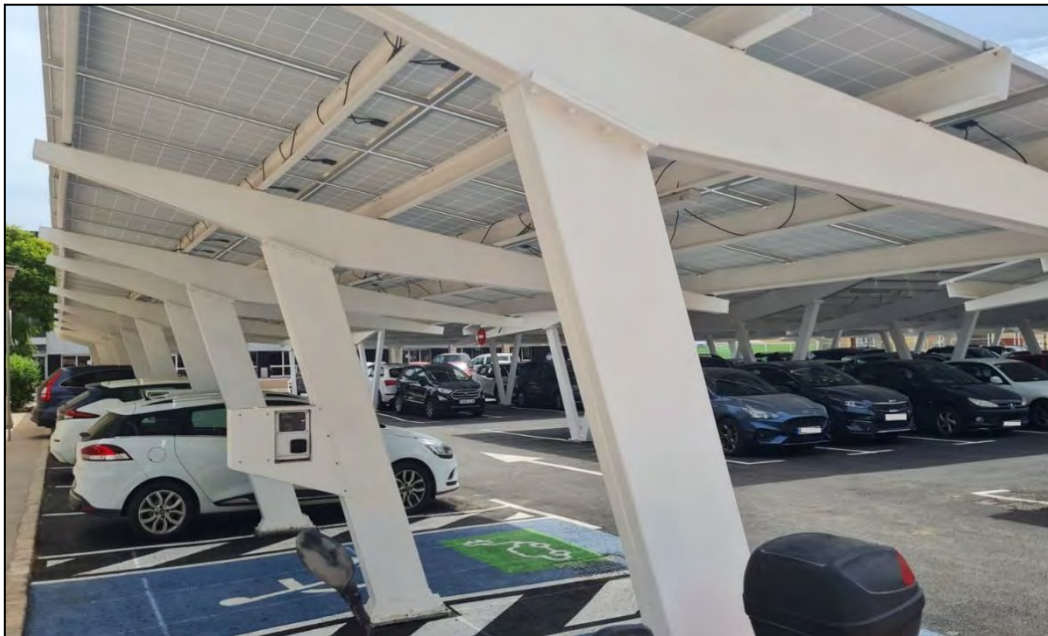
Ilustración 73. Ejemplo de marquesinas fotovoltaicas y punto de recarga.
