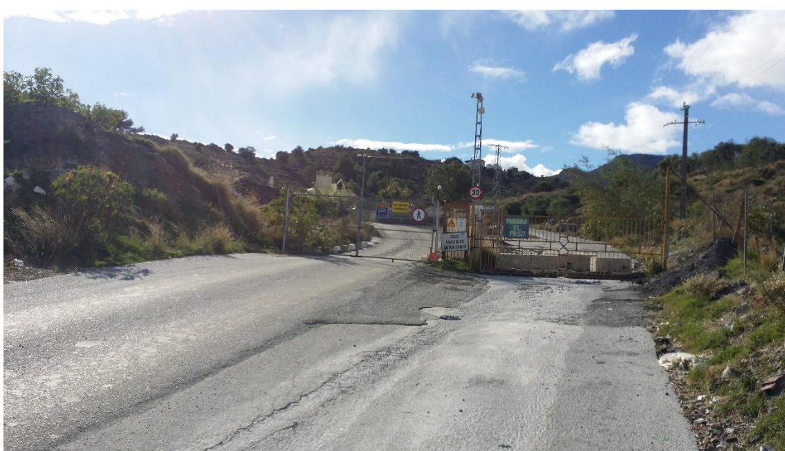
Detalle de la descripción anterior. Se observan arrastres en la misma carretera.
