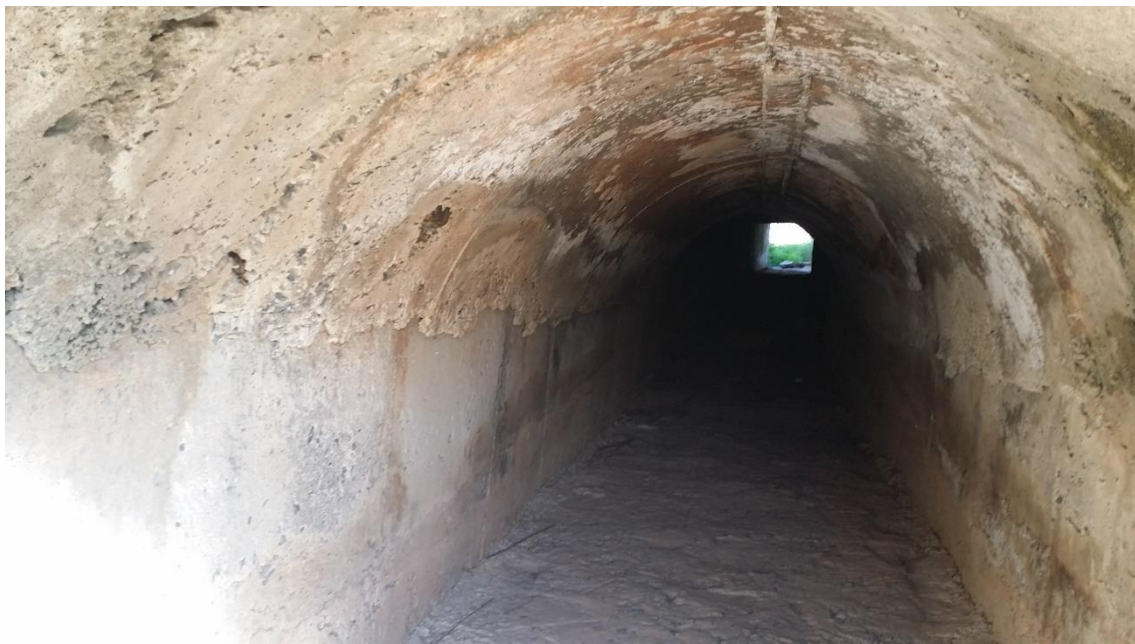
Detalle de la ODT2 y su estado.
