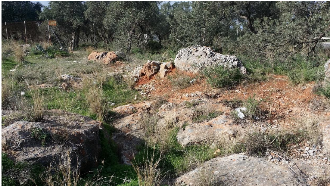
Cauce de la Cañada de la Calera, situación próxima al punto de medición crítico correspondiente con la obra de drenaje ODT 2, perfil 980. Se ve altamente antropización sobre el cual se han vertido rellenos y restos de RCDs.
