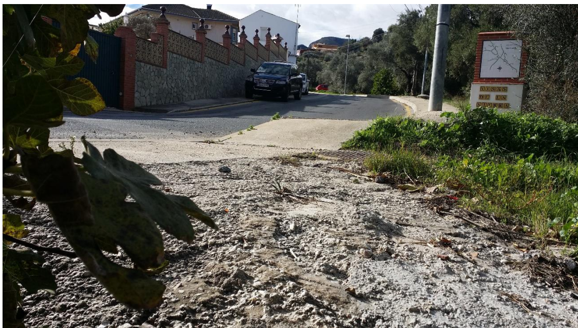
Detalle de la situación descrita anteriormente sobre rasante de la obra de drenaje donde se pueden ver los arrastres.
