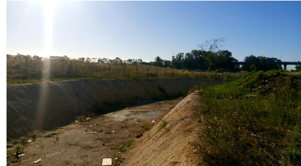
Ilustración 21. Canal trapezoidal hormigonado entre el Guadalhorce y el sector SUS-G2, con ancho en lecho de 5,80 m., y altura de taludes (1/1 aprox.), de 1,60-1,80 m.
