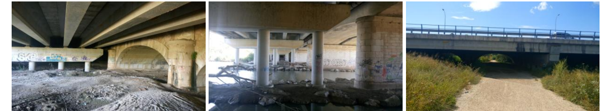
Ilustración 13. Fotografías tomadas bajo el paso de la primitiva N340a (actual MA-21), y aguas arriba, en visitas de mediados de 2017, apreciándose que la sección más desfavorable se corresponde con el puente primitivo.
